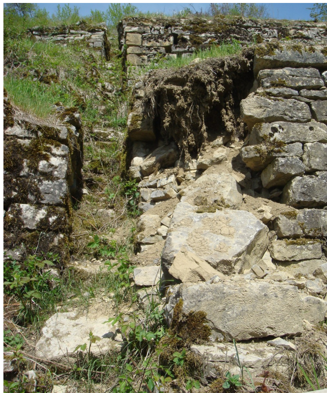
Abb. 16: Einstürzende Trockenmauern am Hofberg bei Möckmühl.
