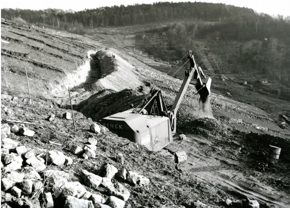
Abb. 11: Bei der Flurbereinigung, hier in der Fellbacher Lage „Lämmeler“, wurde schweres Gerät wie Bagger und Planiertraum eingesetzt.
