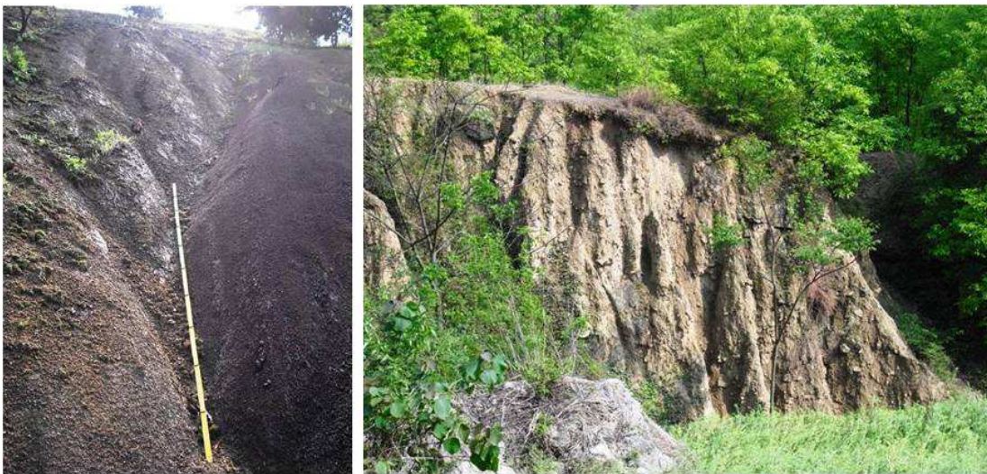
Abbildung 14 Grabenerosion auf schluffig-tonigen Untergrund bei variierenden Hangneigungen: Gullies auf einem für den Anbau von Orangen genutzten, nicht terrasierten Standorts ohne Unterwuchs im südlichen Teileinzugsgebiet Xiangjiaba (links) und Gullies auf einem ungenutzten Standort im zentralen Teileinzugsgebiet Quyuan (rechts). Fotos aufgenommen von S. Schönbrodt (03/2010, 04/2010).
