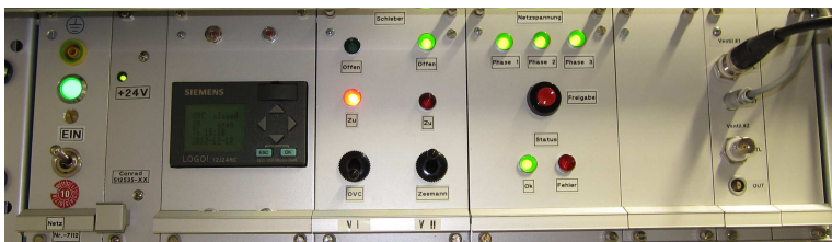
Abbildung 3.8: Frontalansicht der Schiebersteuerung. Links der Hauptschalter und danach die SPS, mittig die beiden Schalter für die Schieber mit Zustandsanzeige, daneben die Spannungsüberwachung für drei Phasen mit manuellem Freigabetaster. Im rechten Einschub wird die Spannungsversorgung für den Betrieb des Ofen-Shutters abgezweigt.
