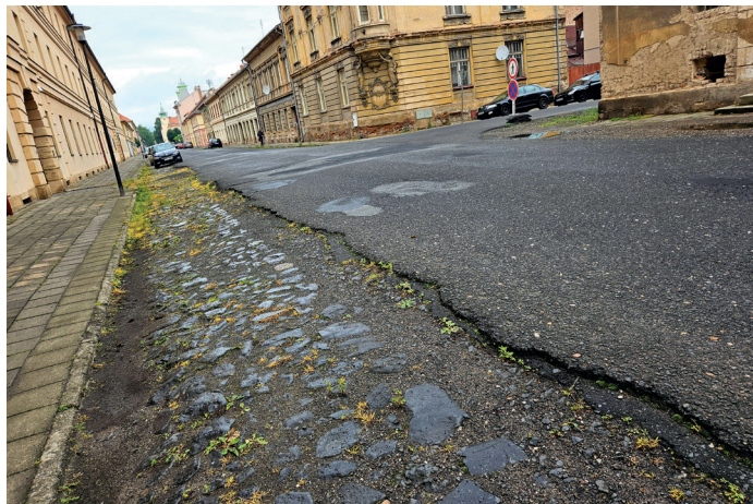
Abbildung 10: Barockzeitliche Fassaden dominieren das Stadtbild in Terezín, die Straßenbeläge und Gehwege zeigen sich oft in reparaturwürdigem Zustand. Foto: Wolfgang Sannwald
